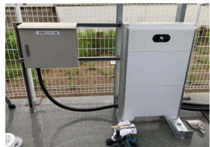
蓄電池と非常用コンセント
